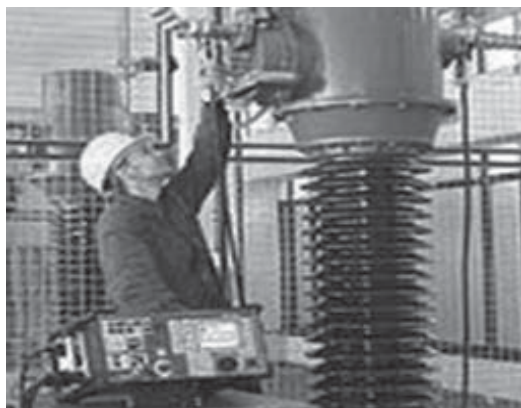
Fig. 2.15 Prueba para transformadores de corriente
