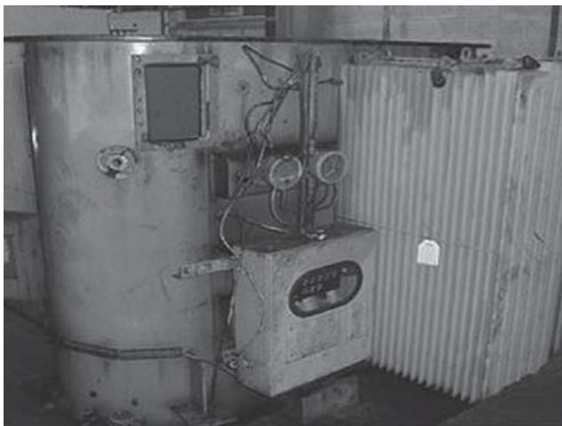
Fig. 1.208 Transformador en malas condiciones
