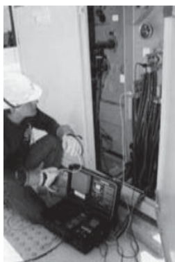
Fig. 2.47 Pruebas realizadas a los transformadores
