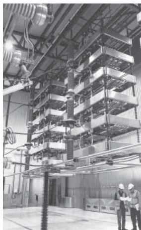
Fig. 2.14 Estación de transformación limpia
