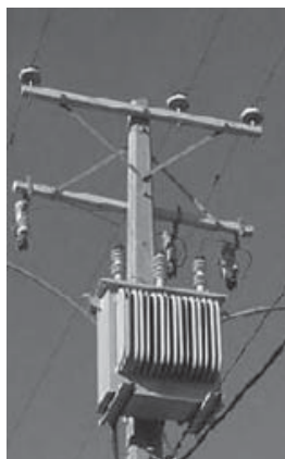
Fig. 1.13 Transformador puesto en servicio
