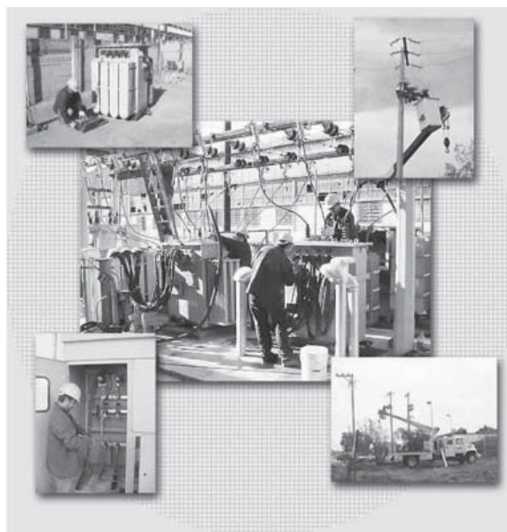
Fig. 1.47 Transformador en mantenimiento
